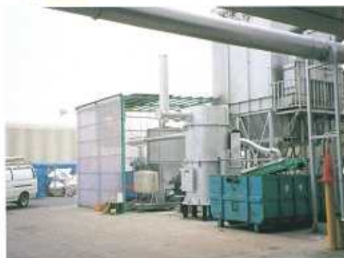
2. コンベヤ排出中に水散布、冷却される。
