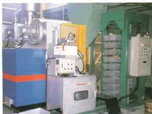
3. 溶融ブロック自動受箱交換
