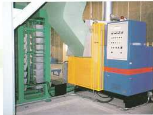
2. 投入コンベヤより溶融口へ直接投入
