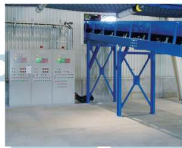
●全自動制御盤 機械本体はもちろん、投入コンベヤー、 排出コンベヤーまで、一括して制御
